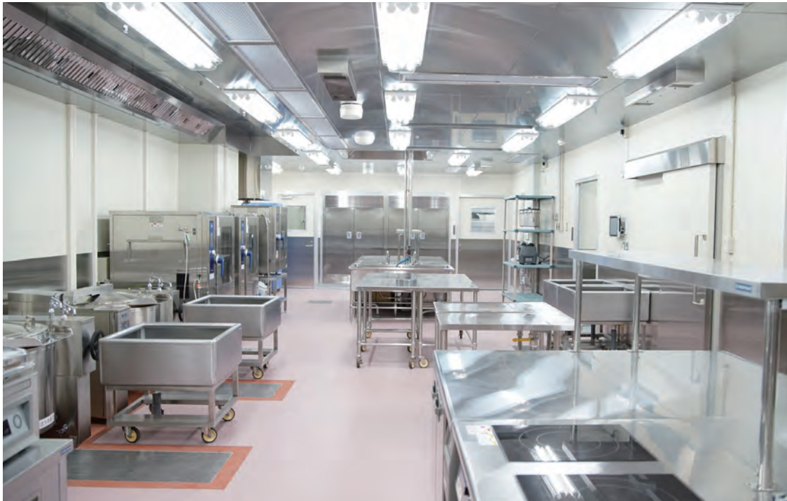
医療福祉セントラルキッチン／加熱調理室 天井換気快潔
